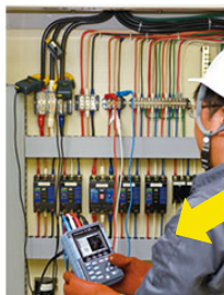
積算電力量の測定
